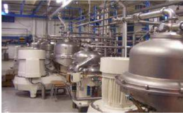
Imagen instalación de centrifugación
