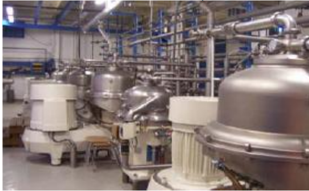
Imagen instalación de centrifugación
