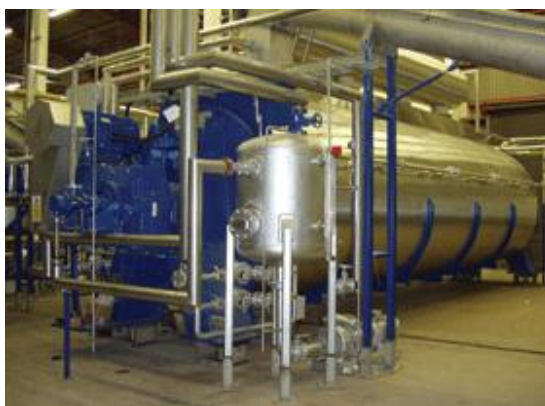
Imagen digester fluidizador
